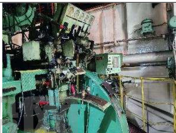
主机机旁应急操控
