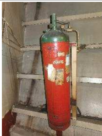
机舱卤代烷灭火器
