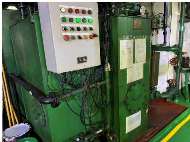
生活污水处理装置
