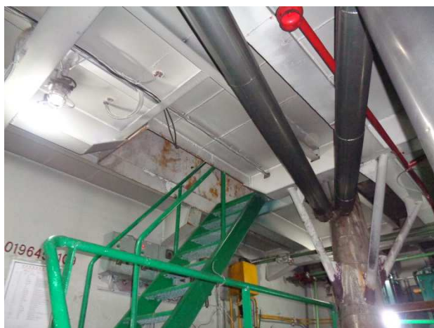
机舱顶部管路
