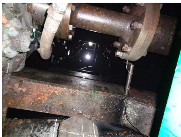
机舱底部管路
