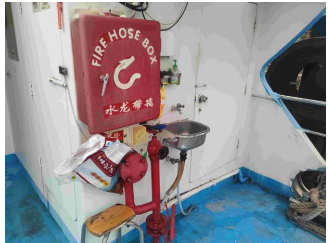
消防栓、消防水带
