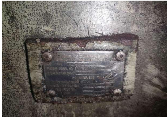
制冷设备铭牌
